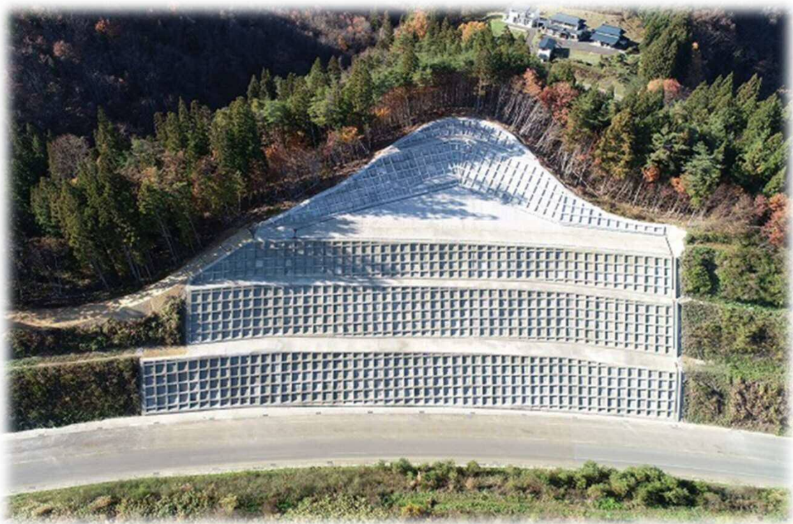
左上：令和3年3月18日に発生した国道397号奥州市江刺藤里地区の法面崩壊状況 右上：災害復旧工事施工状況 下：災害復旧工事の完成（令和4年度完成）
