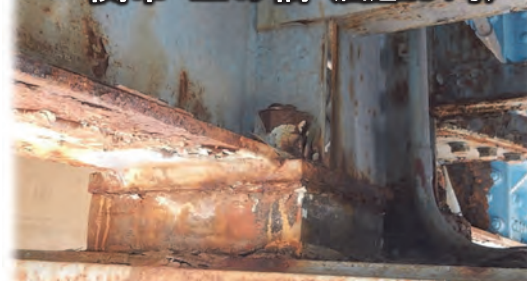
【橋げたの腐食】
