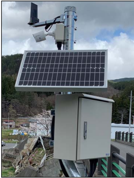
簡易型河川監視カメラ
