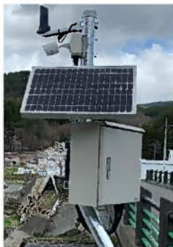
簡易型河川監視カメラ(県)
