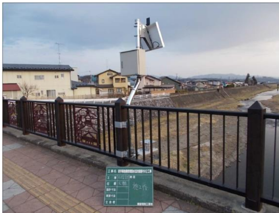
危機管理型水位計設置例（人首川 大橋）
