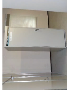
終沈・用水設備コントローラ (更新後 水処理・用水設備コントローラ)
