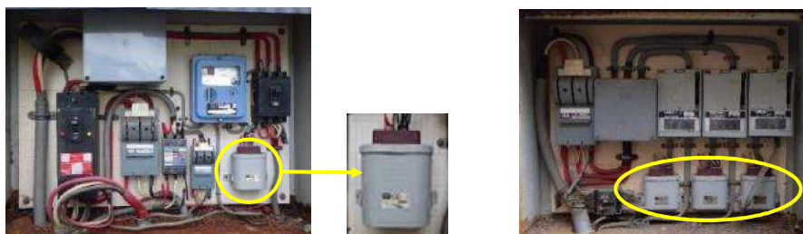
分電盤に設置された低圧コンデンサー
