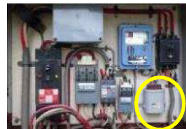
低圧分電盤内の低圧コンデンサー
