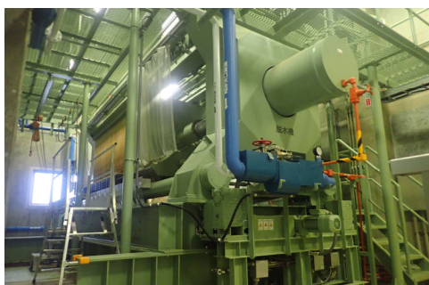
第三浄水場 加圧脱水機(更新後)
