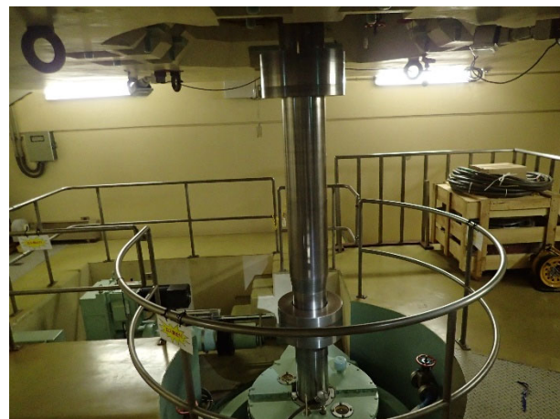
入畑発電所 水車設備
