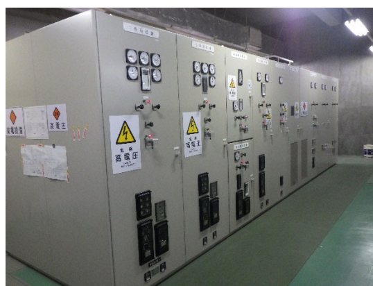
第三浄水場高圧受電設備
