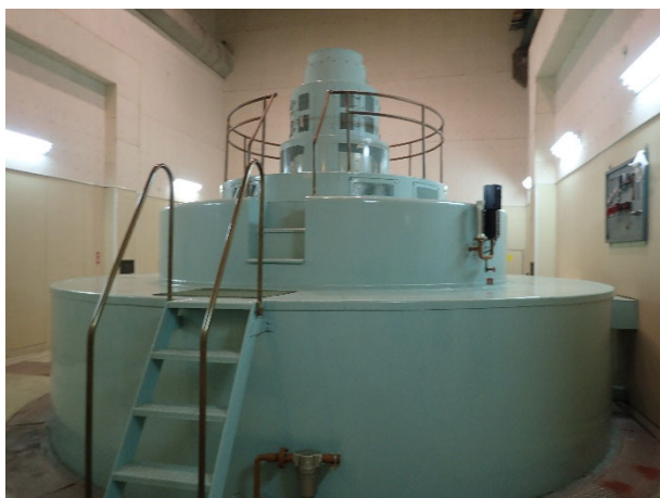
胆沢第二発電所 発電機
