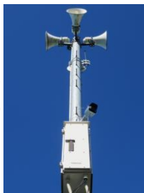
防災システム装置
