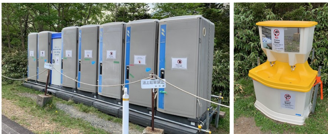
小田越登山口に設置した仮設トイレ及び簡易手洗器
