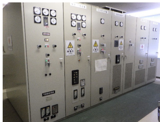
金ヶ崎ろ過施設(第二期) 高圧受電設備
