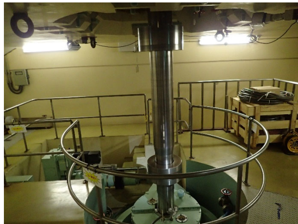
入畑発電所 水車設備
