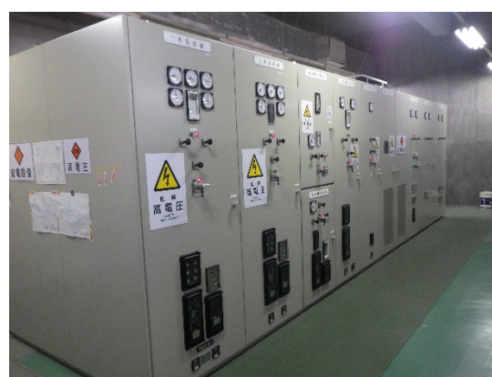
第三浄水場高圧受電設備
