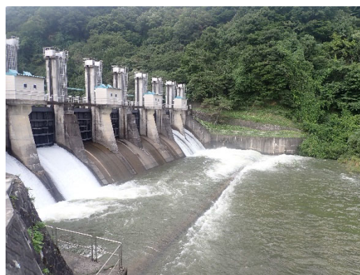
発電用水と農業用水の 共同取水施設である若柳堰堤
