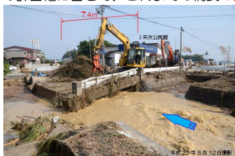
被災直後の岩崎川橋（旧橋）
