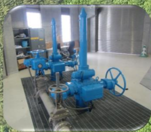
ダム放流設備
