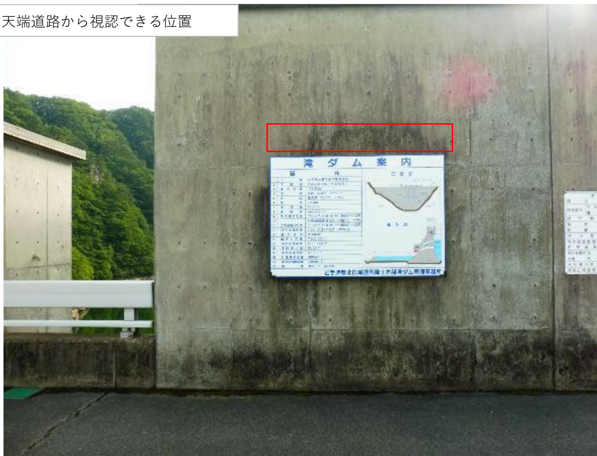
③選択取水ゲート室（外壁へ貼付）
