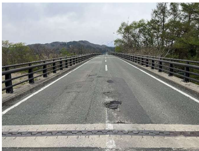
橋面（床版の劣化に伴う舗装の損傷）
